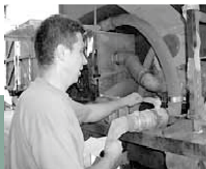
Entre o esguicho de enchimento e mangueira de abastecimento.
